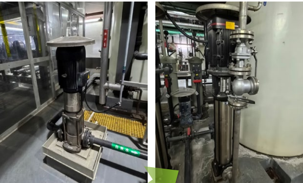
普通泵及配管
